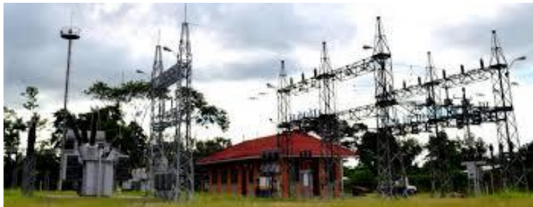
Fotografía 25: Hidroeléctrica que brinda servicio al trópico de Cbba
